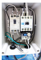
漏電ブレーカー、電磁開閉器で安全に運転ができます。
